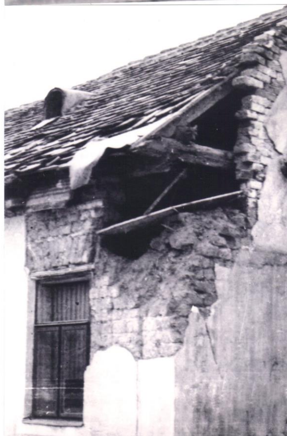
Poškozený dům v ulici Zábraní
