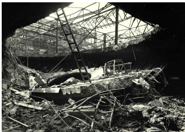
probořená podlaha jedné z montážních hal do skladových prostor v suterénu automobilky Škoda
